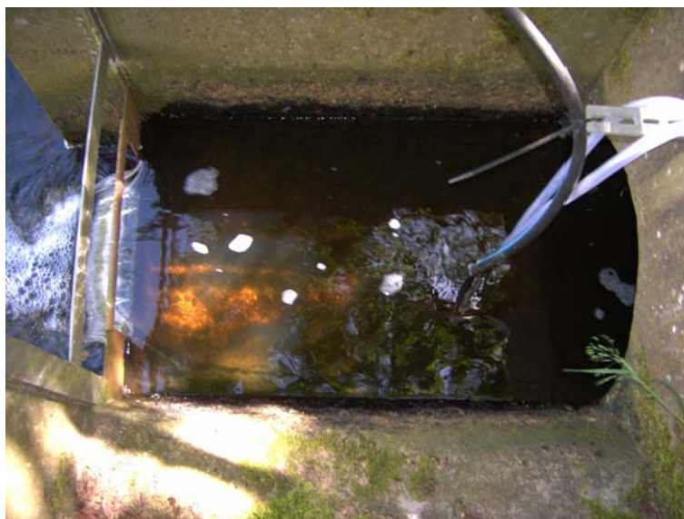
Figur 3 Udtagningssted for døgnprøver i afløb fra Brørup Renseanlæg. De to lyse slanger er fra referencelaboratoriets prøvetagere, mens den mørke slange er fra renseanlæggets egen prøvetager.
